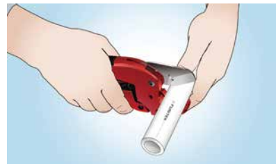
1. Строго перпендикулярно отрежьте трубу необходимой длины, при обрезке не должно образовываться замятий и заусенцев
